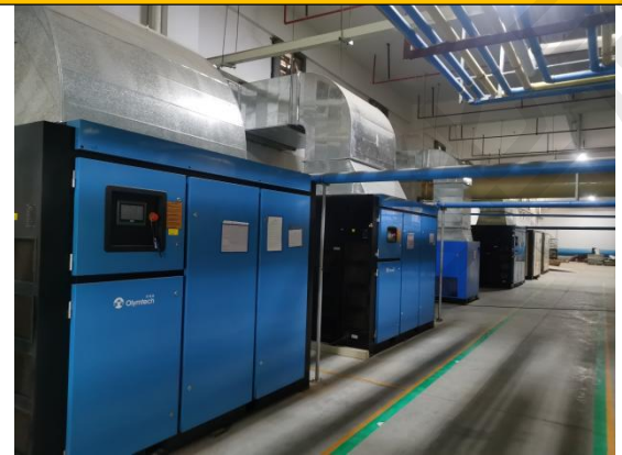
空压机余热回收系统实景图
