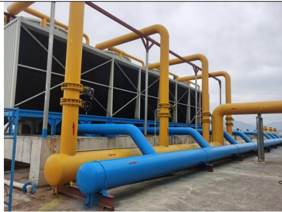
水冷空调实景图
