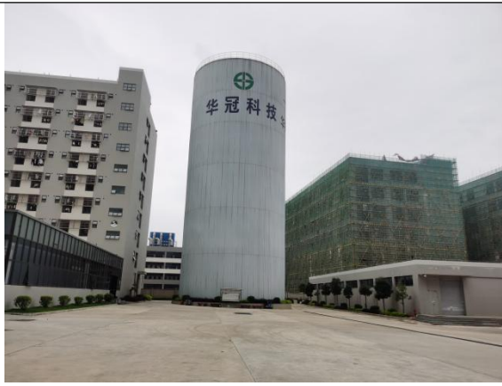
公司水蓄冷空调项目
